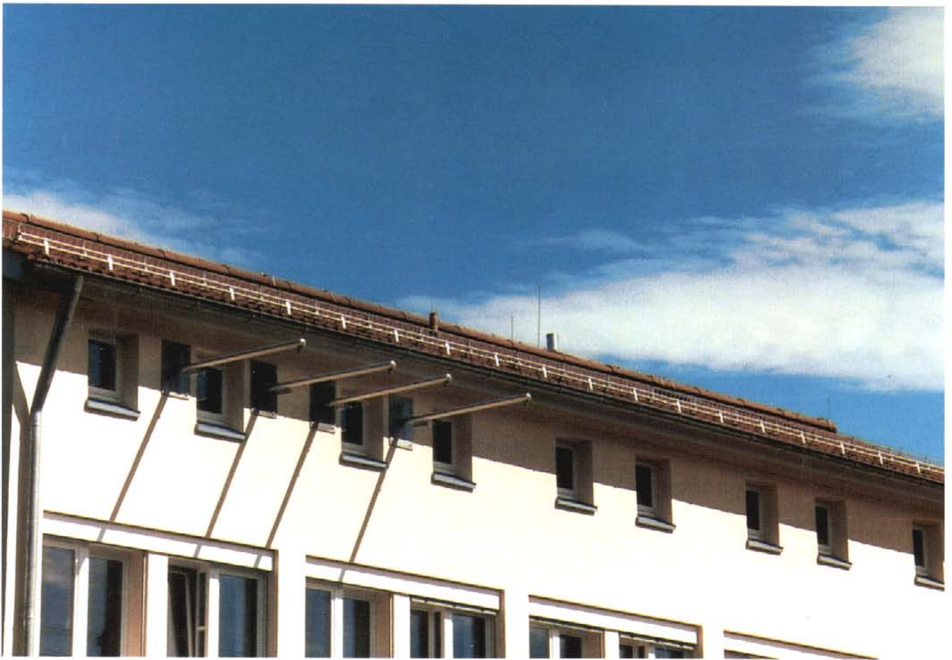
obrepa Doppelrohr-System auf dem Vermessungsamt Lohr a. Main
